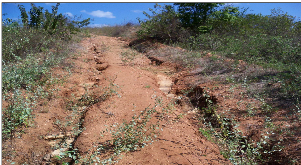
Figura 5.7: Erosões (ravinas) marcantes na microbacia do Riacho Namorado. São João do Cariri - PB. Foto colhida pela autora em: 01/09/2011.
