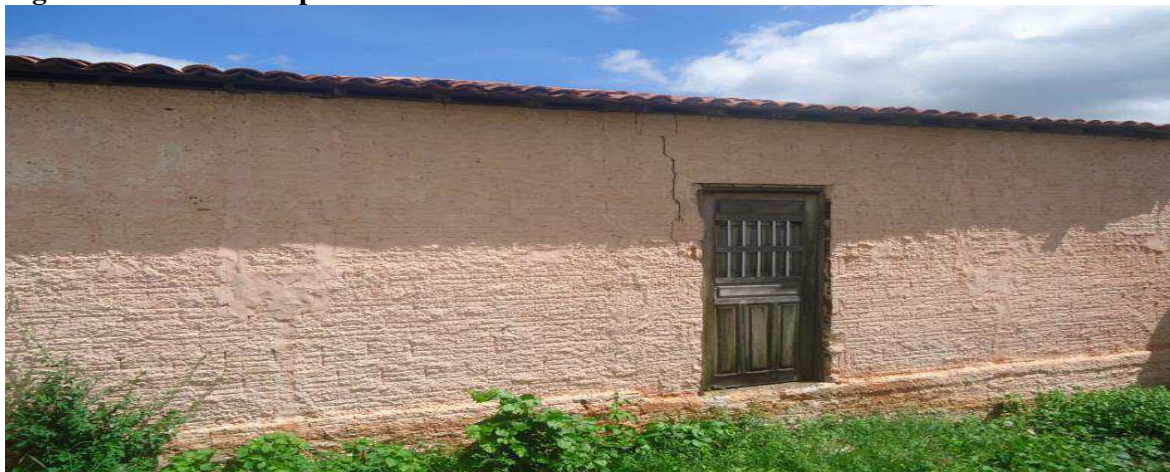
Figura 16-Fissuras nas paredes das casas
