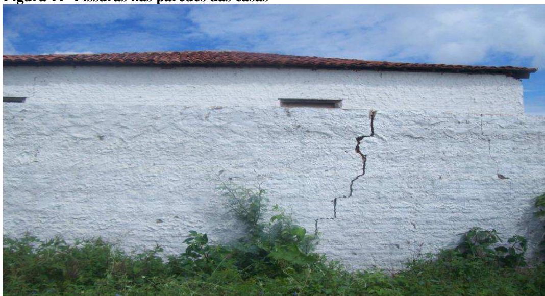
Figura 11- Fissuras nas paredes das casas
