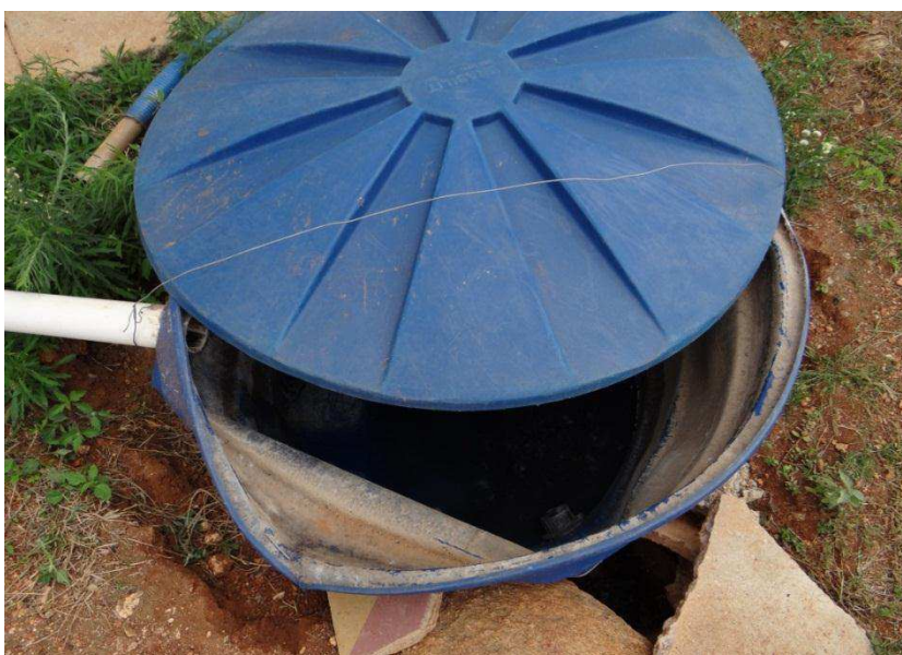
Figura 12 – Reservatório de armazenamento e distribuição de efluente.
