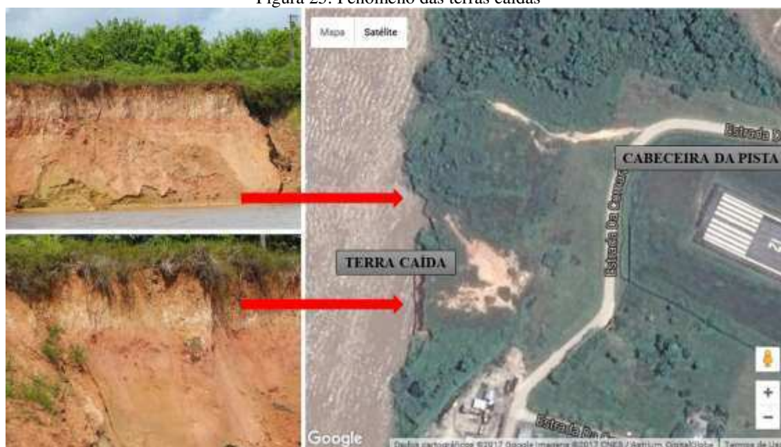
Figura 25: Fenômeno das terras caídas
