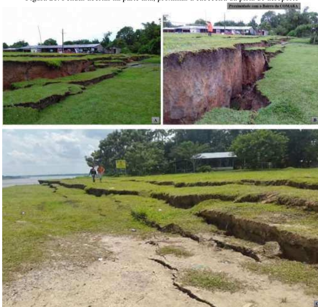
Figura 26: Fendas abertas na parte alta, próximas à cabeceira da pista do aeroporto
