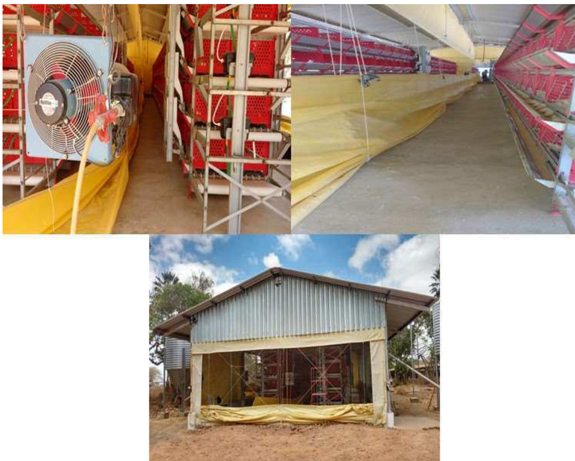
Figura 4. Sistema de aquecimento
