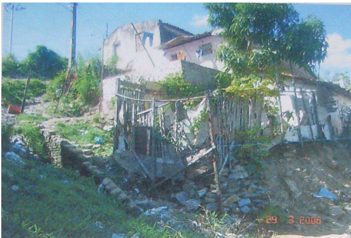
Fotografia de parte da escadaria e anexo de uma casa destruído em função das chuvas. Fotografia do acervo da Cehap.
