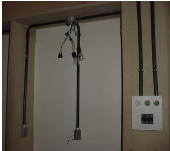
Figura 4. Fotografia das cabines de instalações elétricas prediais.
