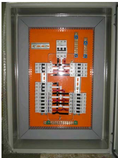
Figura 2.1. Quadro de distribuição de baixa tensão de instalações prediais.
