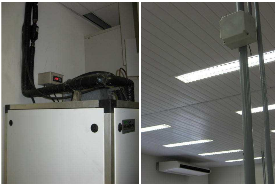
Figura 7: Controladores implantados no RH (foto da esquerda) e na sala da Manutenção (foto da direita)
