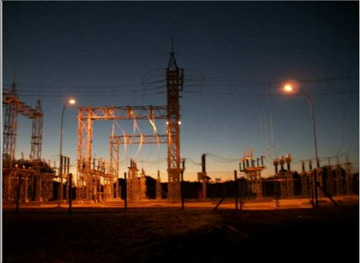
Figura 22. Subestação 69 kV, Usina Hidrelétrica São José-RS (2011).
