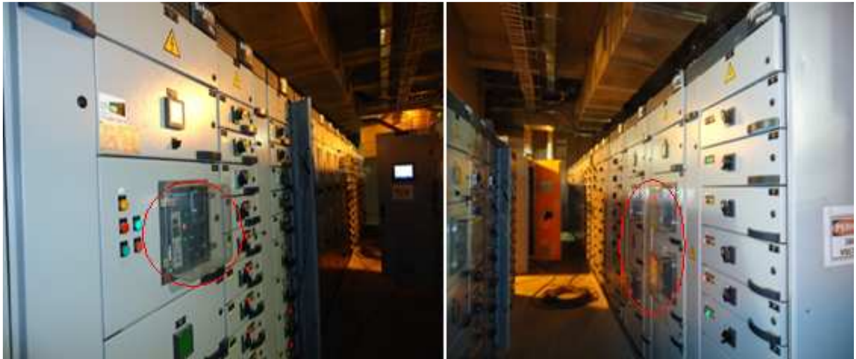
Figura 20. (a) Centro de Controle dos Motores e Quadro Geral dos Serviços Auxiliares, com proteção de disjuntores extraíveis, UHE São José-RS (2011).
