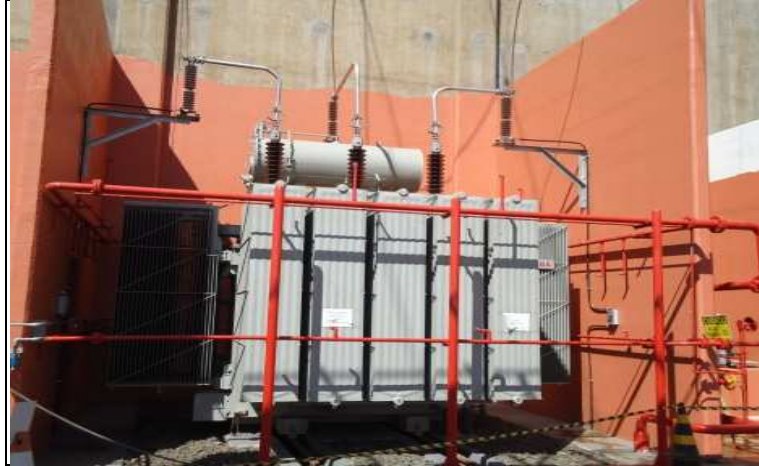
Figura 21. Transformador Elevador 13,8 kV/69 kV, UHE São José-RS (2011).
