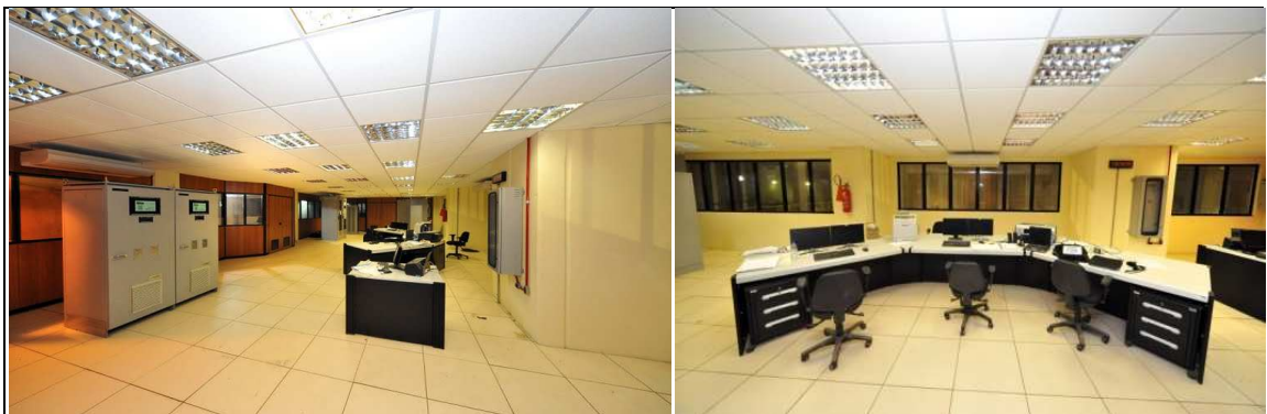
Figura 19. Sala de Controle da UHE São José-RS (2010).
