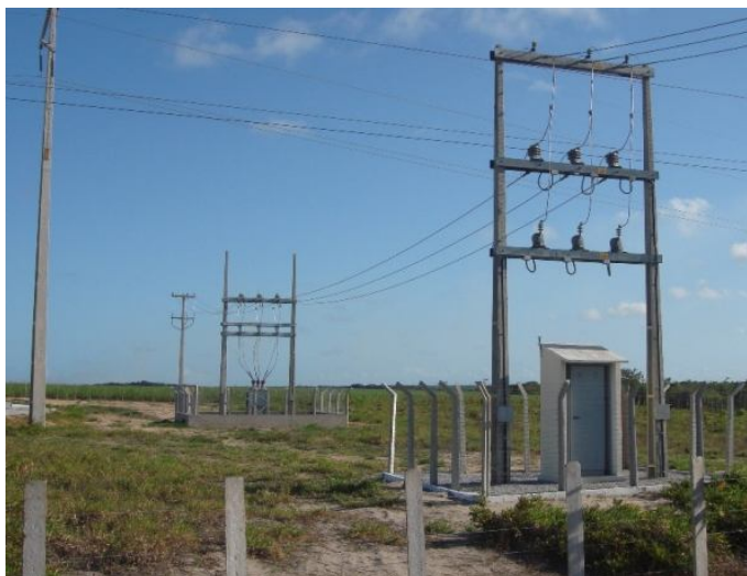
Figura 5.8 - Casa de controle e comando do parque Vitória.
