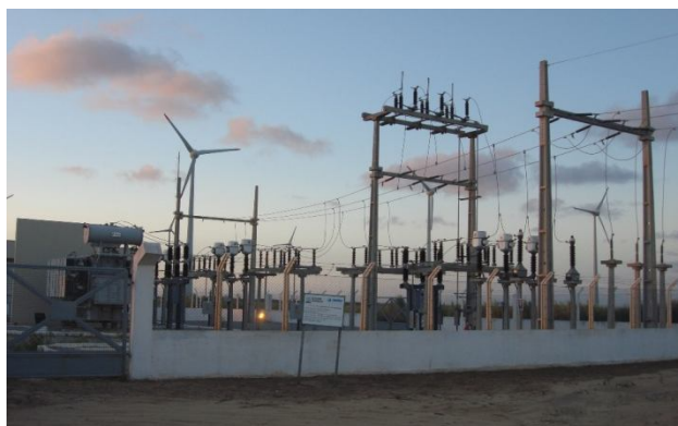
Figura 5.12 - Subestação do parque Vale dos Ventos.
