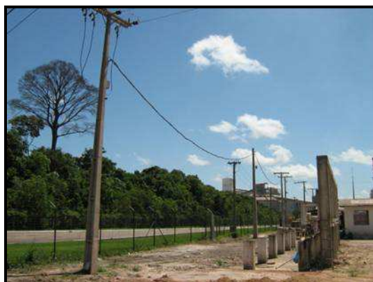
(a) Cabo isolado.
