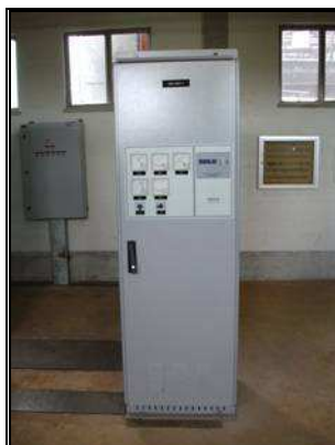
Figura 3. 18 - Conjunto carregador de baterias.
