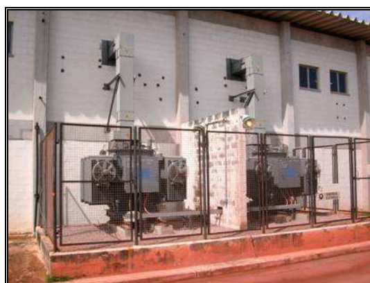
(b) Transformadores 4,16 kV - 480 V.
