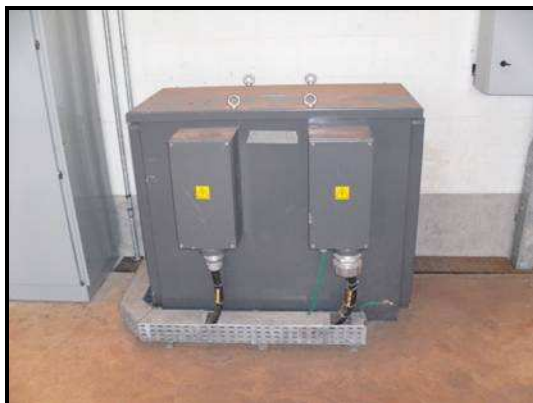
Figura 3. 17 - Transformador auxiliar 480 V - 230 V/133V.
