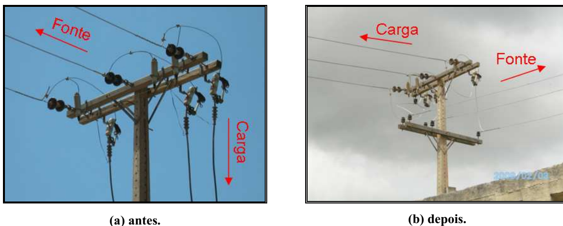
Figura 3. 6 - Inversão no sentido da chave fusível.
