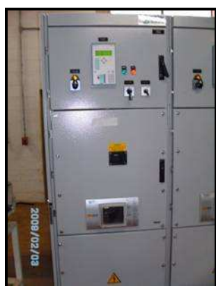
Figura 3. 1 - Detalhe coluna de instalação do disjuntor.
