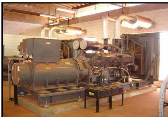
Figura 2. 8 – Grupo Gerador de Emergência
