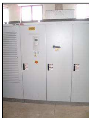
(a) Detalhe inversor de frequência em 4,16 kV.
