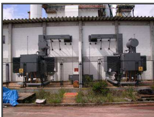
(a) Transformadores 13,8 kV – 4,16 kV.
