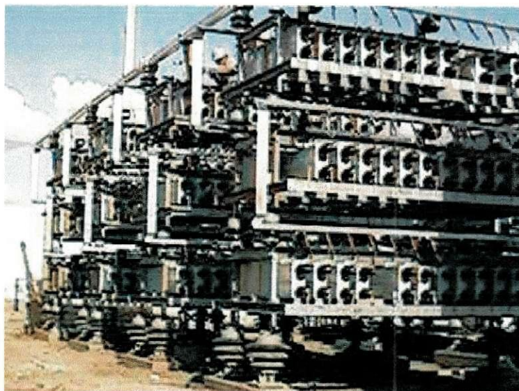
Figura 7.1 - Fase de um dos bancos de capacitores.
