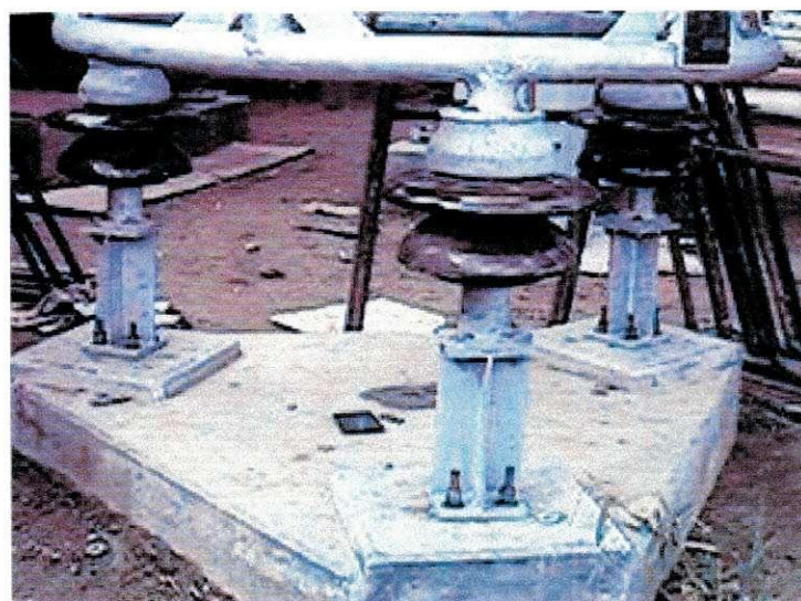
Figura 7.3 - Isoladores pedestal dos reatores série.
