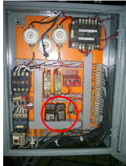
Figura 7: Relé Schrack de pinos e comando elétrico da ensacadeira
