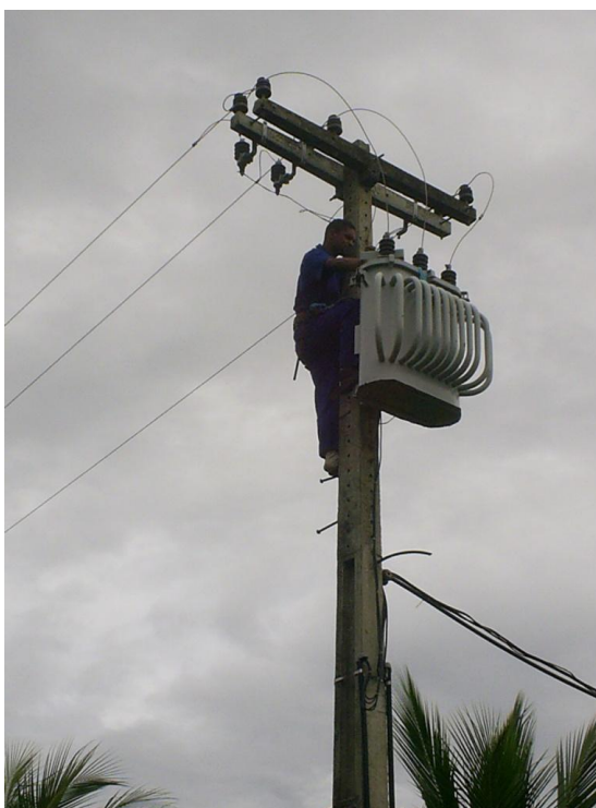
Figura 11: Eletricista terceirizado realizando a mudança do tap no trafo de 45 kVA
