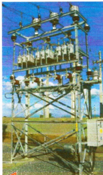
Figura 19 – Banco de capacitor (01H1)
