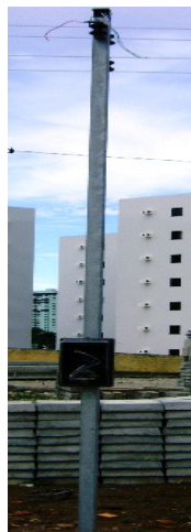
Figura 1 - instalação em poste auxiliar
