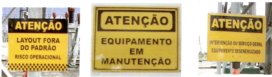
Figura 26 – Sinalização de área em manutenção
