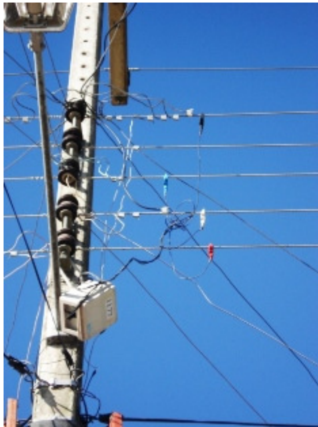
Figura 8 – Aparelho instalado na entrada do cliente
