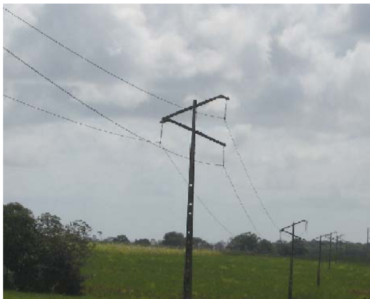
Figura 3 – Linha de Transmissão 69 kV
