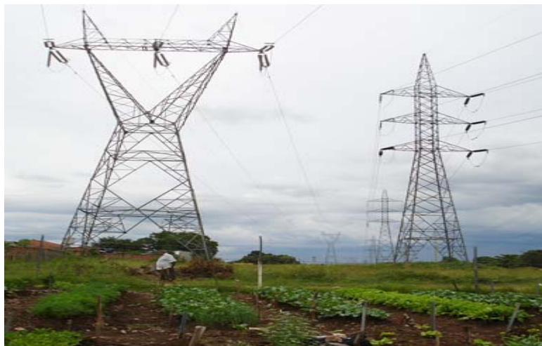
Figura 2 – Linha de Transmissão 230 kV
