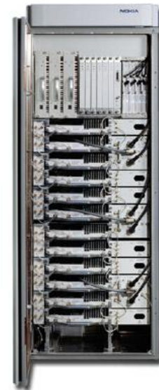
Figura 6 – Estação Rádio Base
