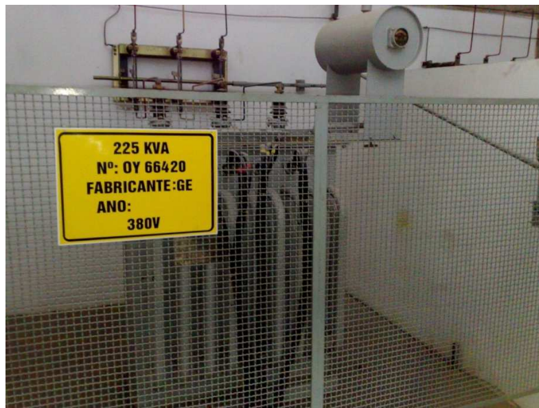
Fig. 7. Transformador de 225 kVA.
