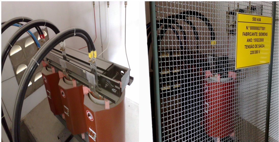
Fig. 8. Transformador de 500 kVA.
