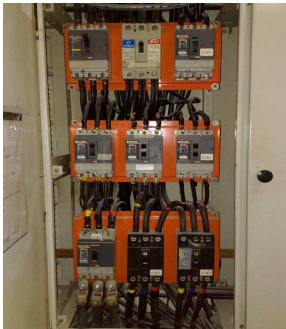
Fig. 9. Quadro de distribuição.
