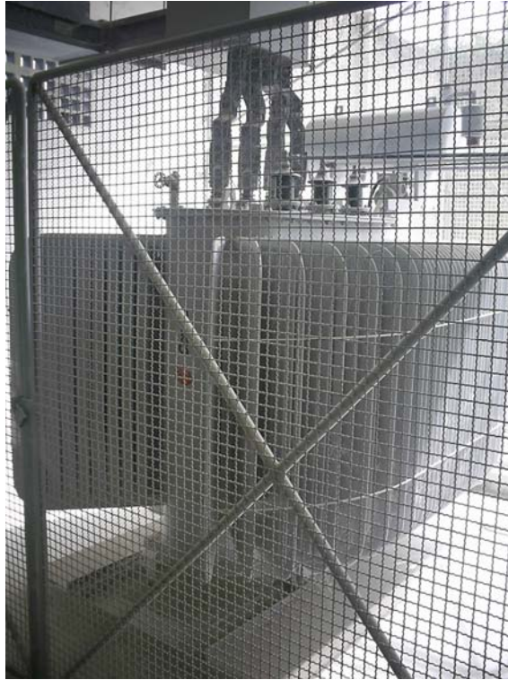
Figura 4.3 - Transformador de 1500 kVA
