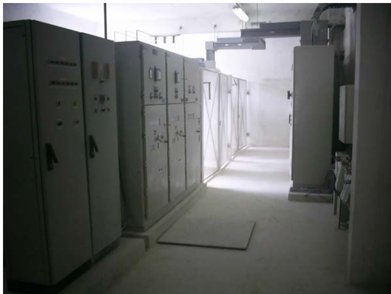
Figura 4.2 - Subestação abrigada 1 da Elizabeth Porcelanato
