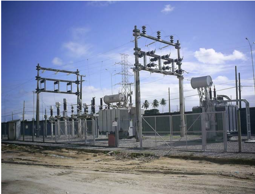
Figura 4.1 - Subestação de 69 kV da Elizabeth Porcelanato
