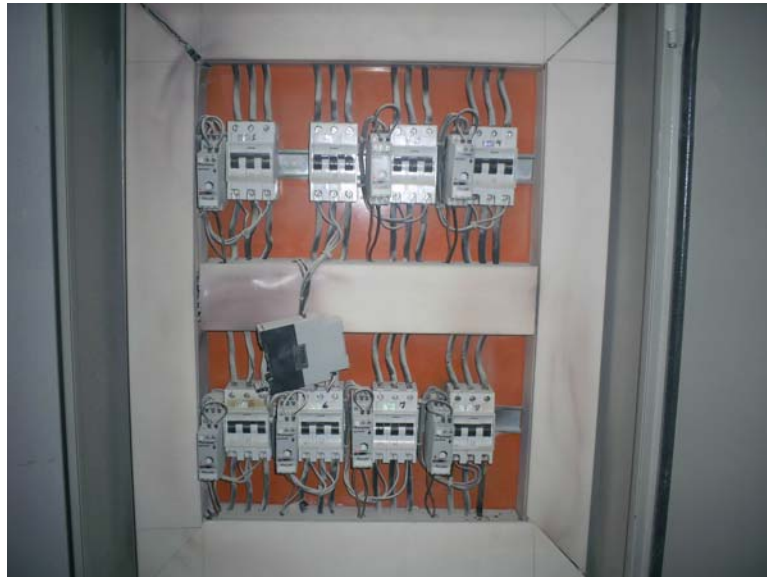
Figura 7.5 - Quadro do banco de capacitor antes da manutenção
