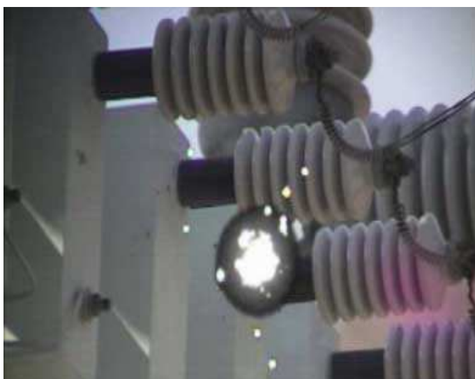
Figura 1.6 – Descargas em banco de capacitores.
