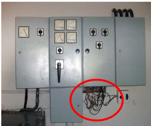
(a) Quadro de Distribuição.
