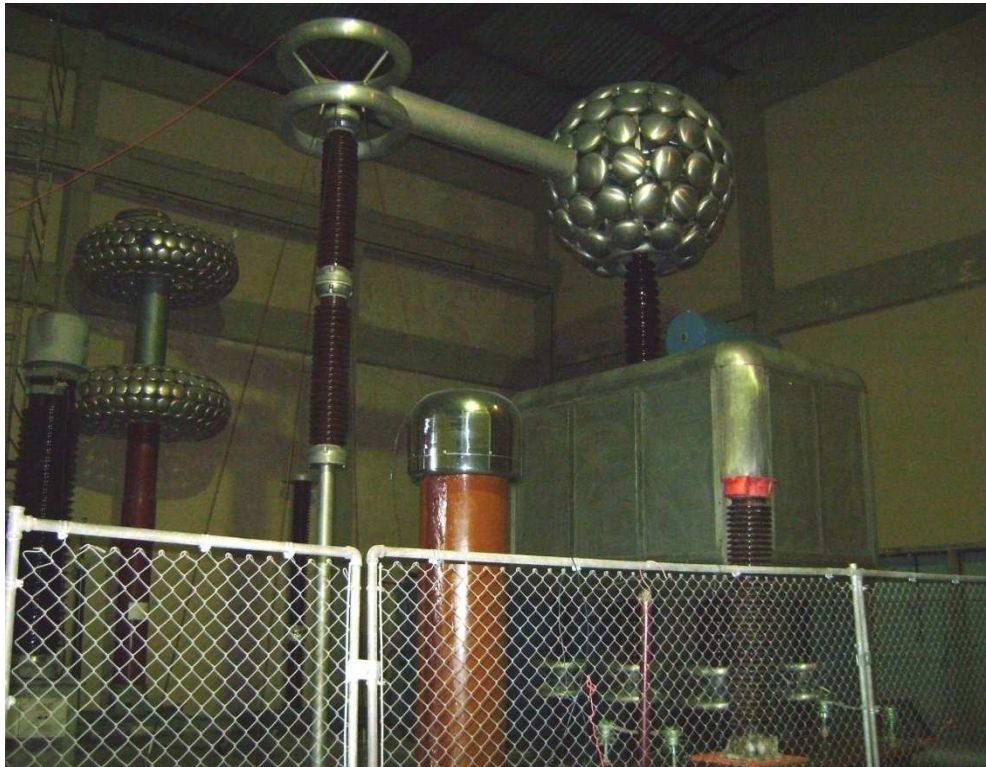
Figura 1.1 - Salão de Alta Tensão.
