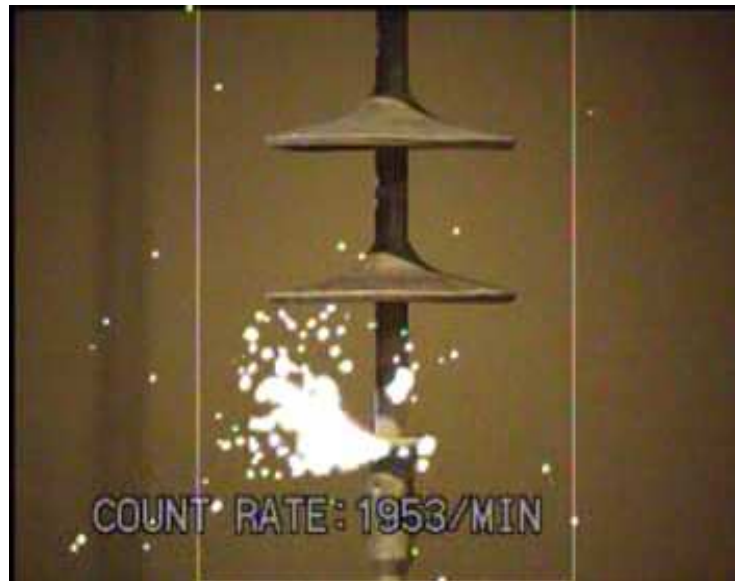
Figura 1.7 – Inspeção de radiação ultravioleta em isolador polimérico.
