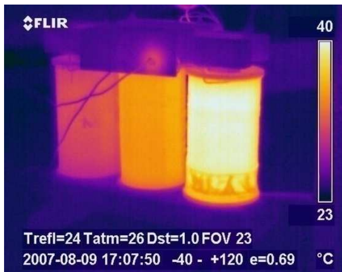
Figura 1.5 - Termovisão de transformador com um dos enrolamentos sobrecarregado.
