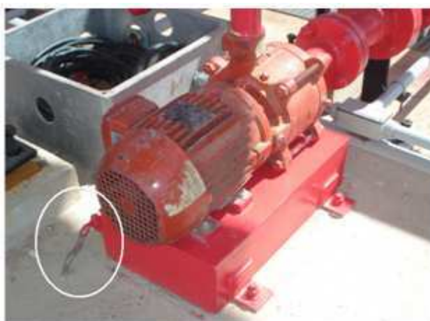
Figura 4.11 – Correção do aterramento dos motores
