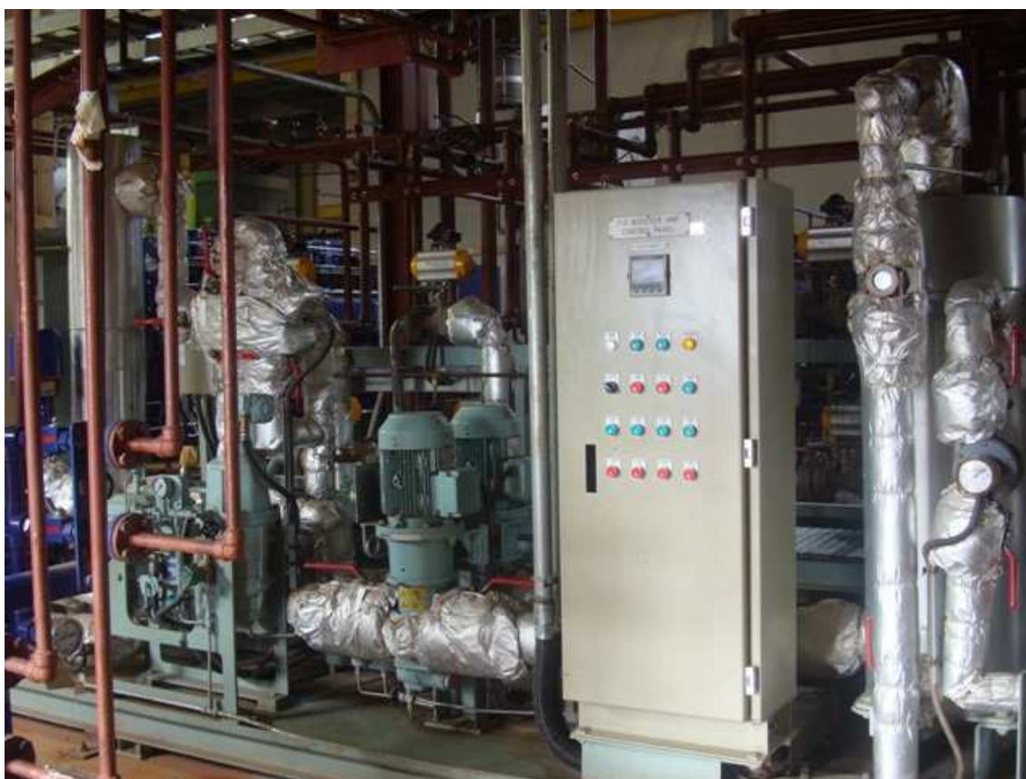
Figura 3.3 – Sistema elevador de pressão Boosters .
