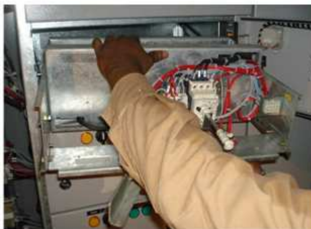
Figura 4.12 – Comissionamento das gavetas dos painéis de Baixa tensão .
