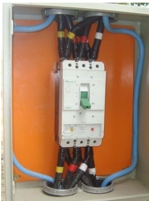
Fig. 14 – Vista do disjuntor geral no poste
