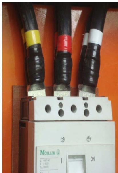
Fig. 13 – Vista dos cabos chegando ao disjuntor geral (2 cabos por fase)
