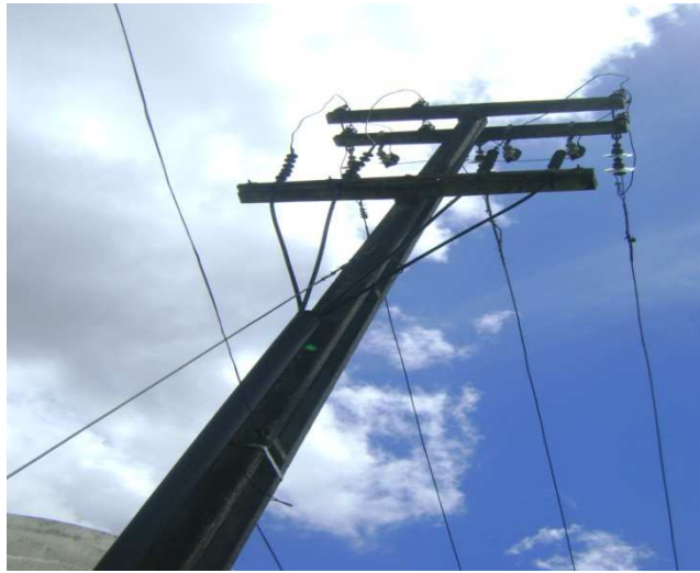
Figura 2.09 – Pára-raios instalados na Saída da Cabine.
