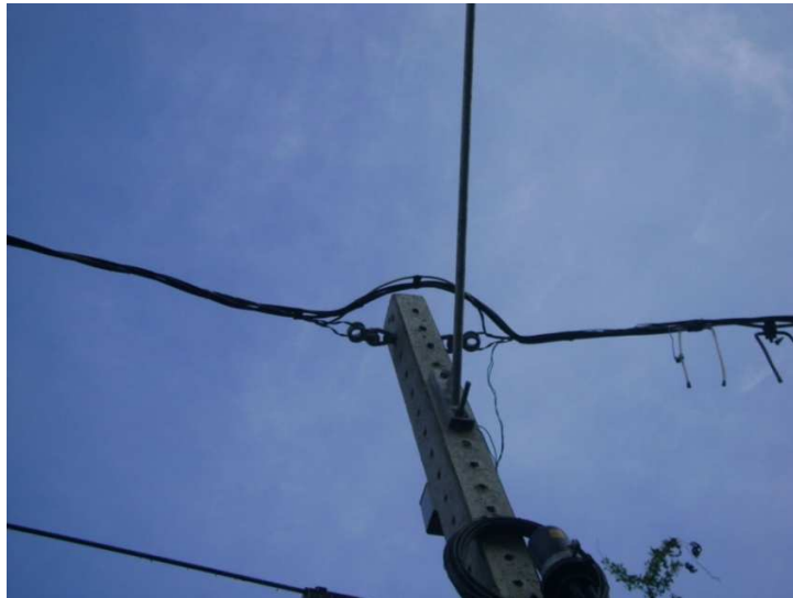
Figura 2.05 – Rede de Baixa Tensão Multiplexada.
