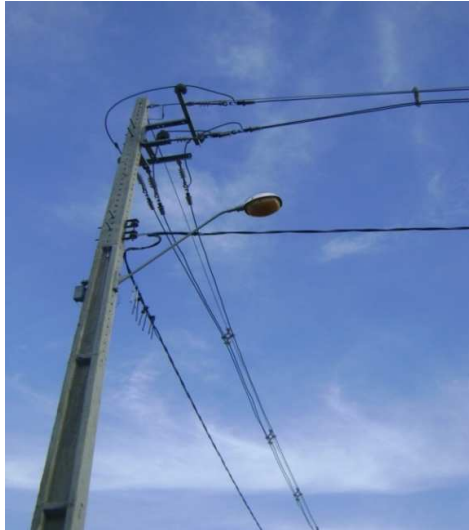
Figura 2.03 – Rede de Média Tensão Compacta.
