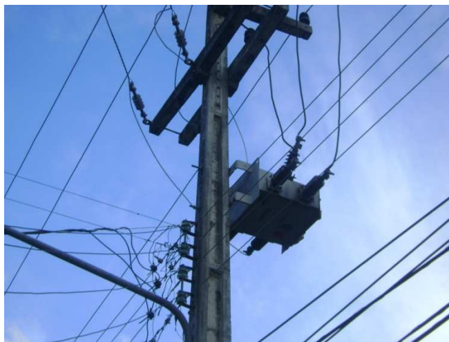
Figura 2.12 – Chave à Óleo instalada no Campus.
