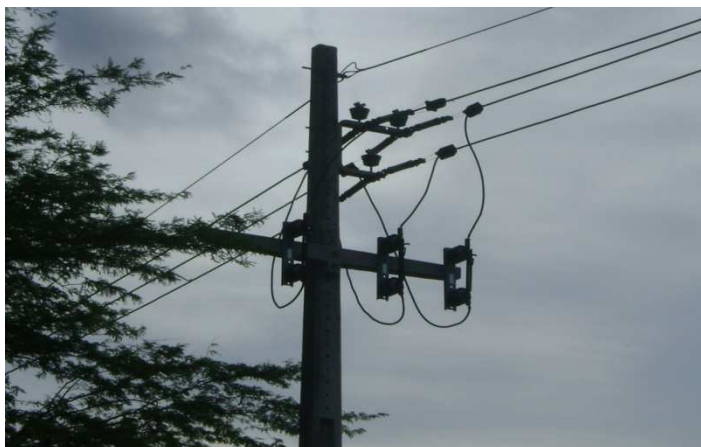
Figura 2.11 – Chave Seccionadora instalada na Rede Primária Compacta.
