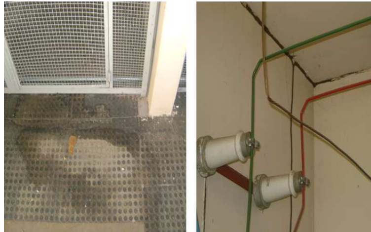
Figura 2.15 – Pontos de Infiltração e Colônias de Cupins na Cabine.
