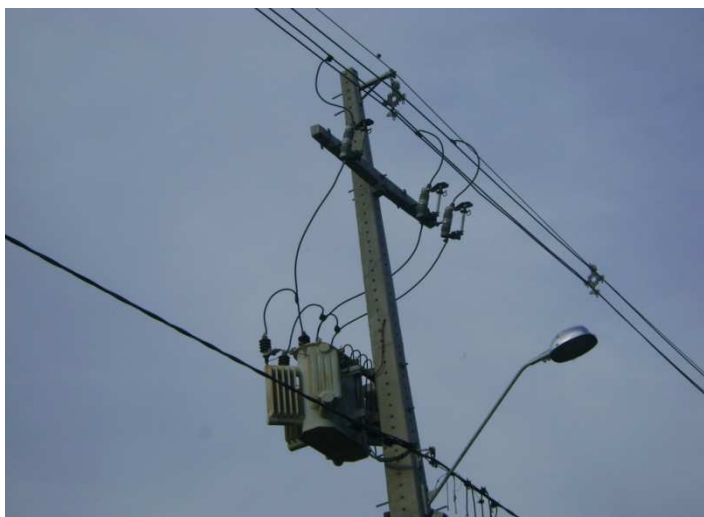
Figura 2.10 – Chave Fusível instalada no Campus.
