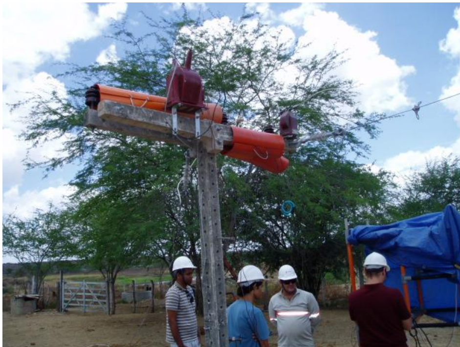
Figura 26: Poste de transição com TP e TC instalados
