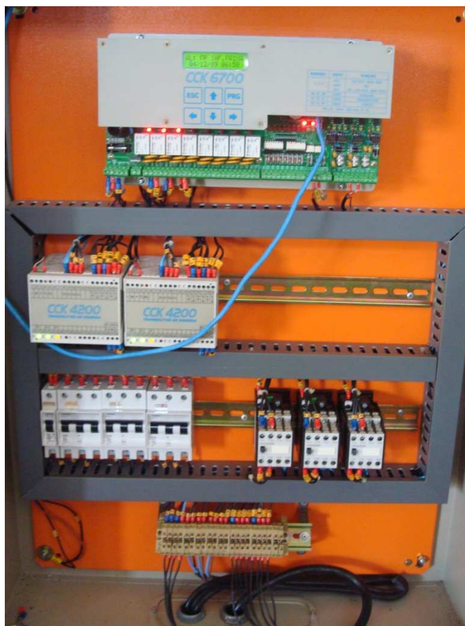
Figura 2.14 – Quadro do Gerenciador de Energia CCK 6700.
