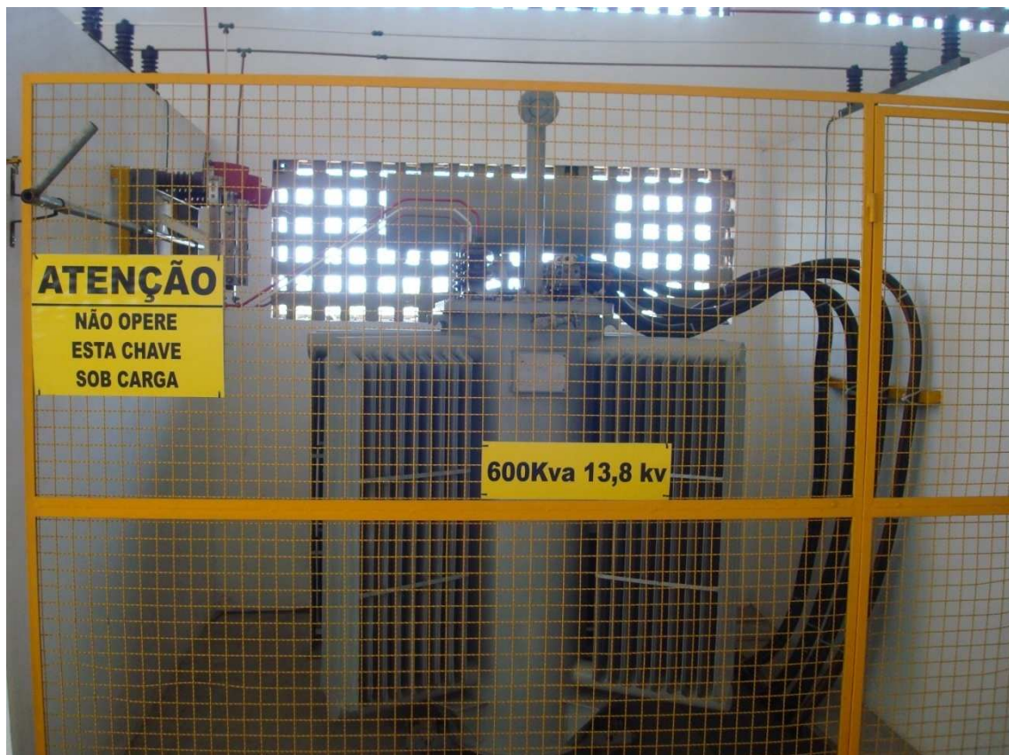
Figura 2.3 – Transformador de 600 kVA – 13.800/ 380 V.
