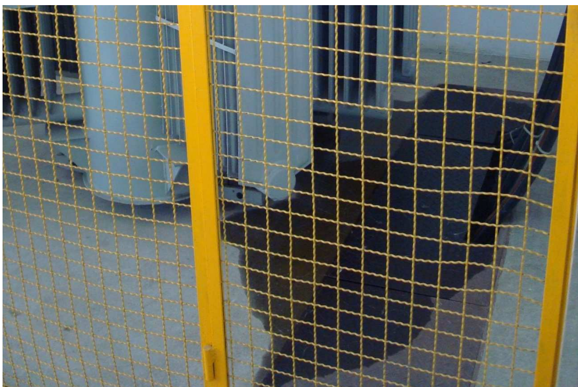
Figura 2.4 – Poça de óleo devido ao vazamento do trafo.
