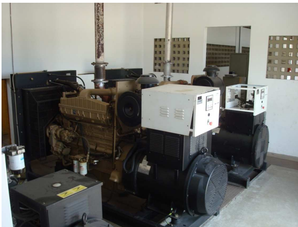
Figura 2.12 – Geradores G1 e G2
