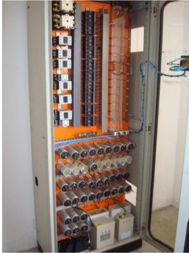
Figura 2.9 – Banco de Capacitores.
