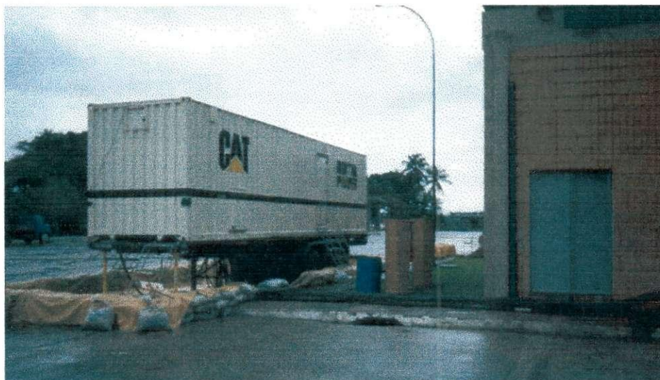
Figura 5. Foto do Gerador fabril a Diesel Caterpillar de 2.000 kVA
