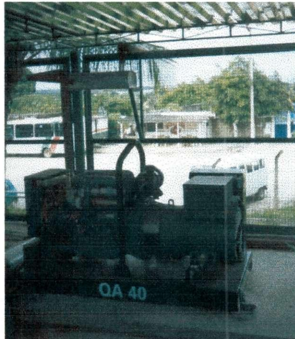
Figura 7. Foto do Gerador de Emergência do CDD
