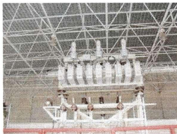
Figura 2.2: Banco de Capacitores
