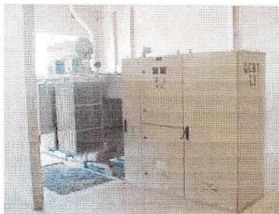
Figura 2.1: Subestação Secundária - QGBT
