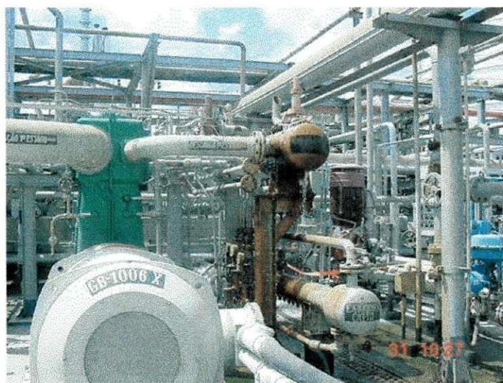
Figura 4 – Exemplo de Montagem Instrumental: Sistema de Ventilação dos Fornos de FOTOGRAFIA Pirólise.
