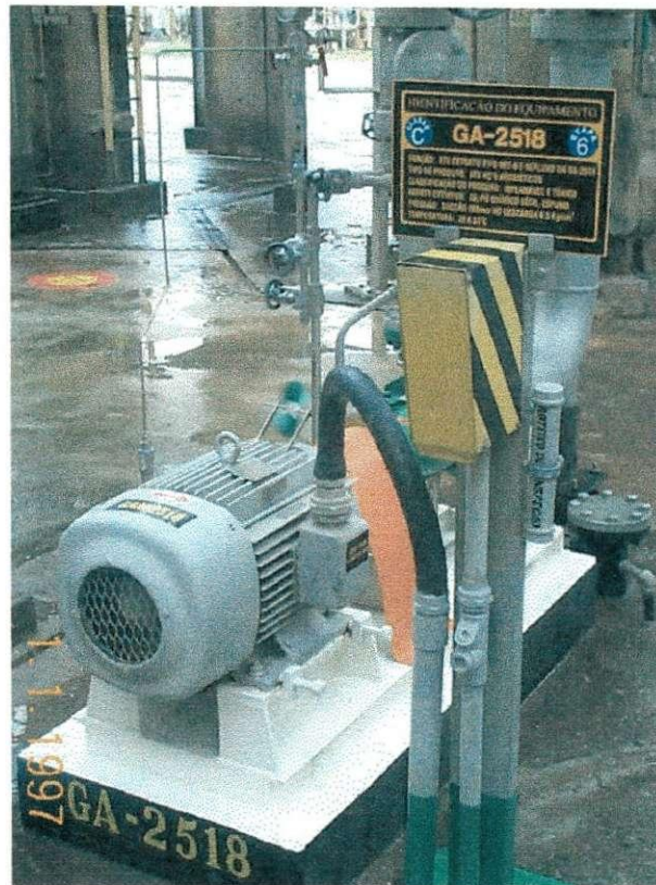
Figura 3 – Exemplo de montagem elétrica: bomba na Central de Matérias Primas - CEMAP.
