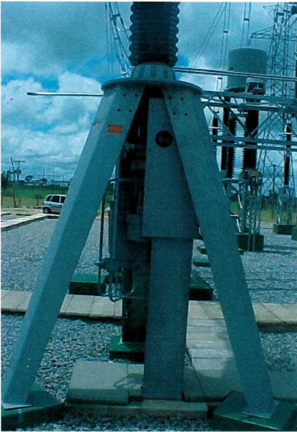
Fig. 11 (Base do Disjuntor)
