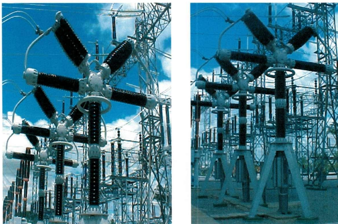
Fig. 10 (Disjuntor VATECH 230 KV)
