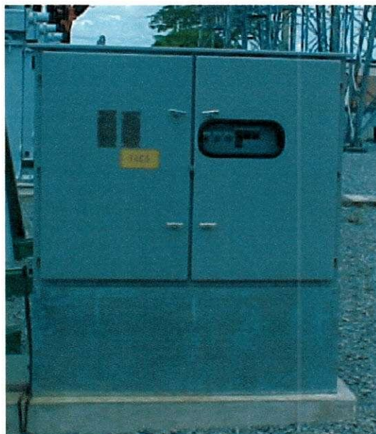
Fig. 13 (Caixa de Comando do Disjuntor)
