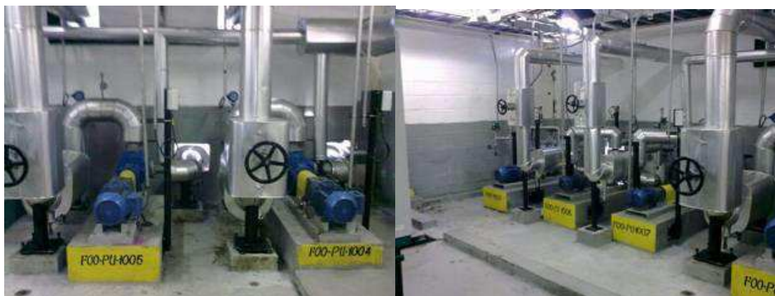
Figura 4.5 – Sala de bombas
