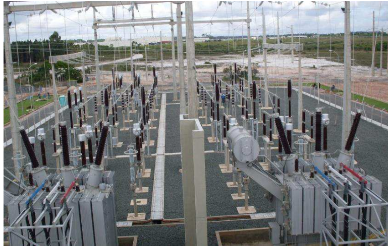
Figura 4.15 – Subestação Elevadora da UTE Muricy I.
