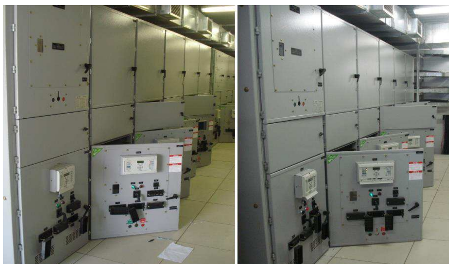
Figura 4.14 – Painéis de 13,8 kV
