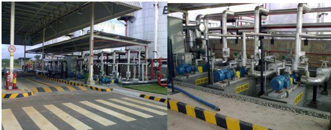
Figura 4.4 – Baia de descarregamento de óleo pesado
