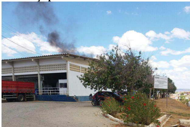
Figura 20- Fumaça proveniente da chaminé da caldeira.
