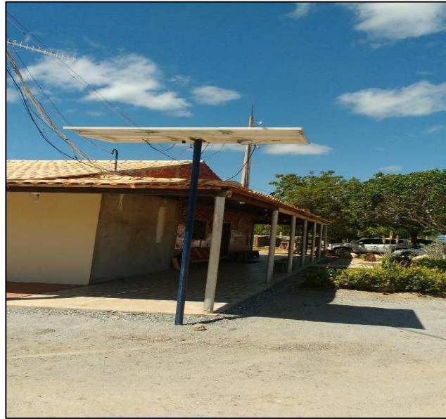
FOTO 15 - Placa solar para abastecimento do escritório
