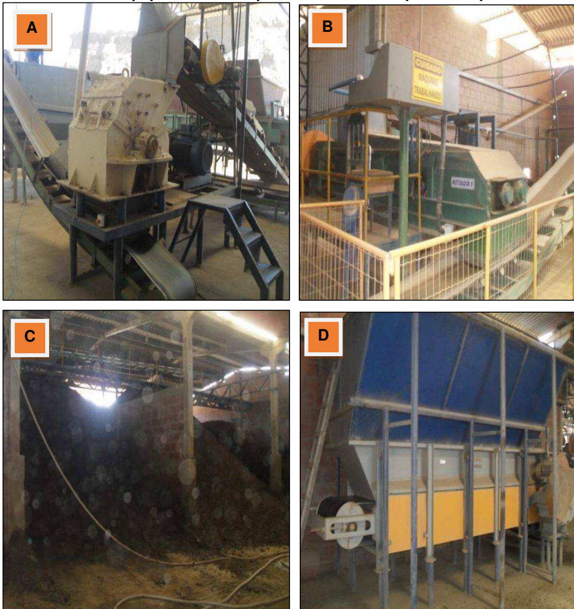
FOTO 3 - Equipamentos/máquinas utilizadas no processo produtivo
