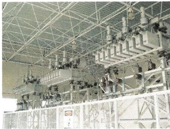
fig. 2.11 - banco de capacitores instalados na sala da elétrica
