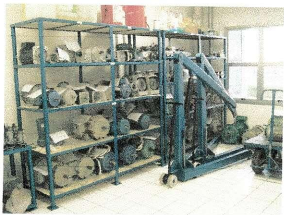
fig. 1.31 - sala de motores
