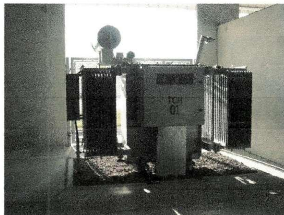
fig. 2.8 - transformador 13.8kV / 4.16kV na sala da elétrica
