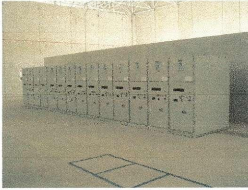
fig. 2.9 - cubículos instalados na sala da elétrica
