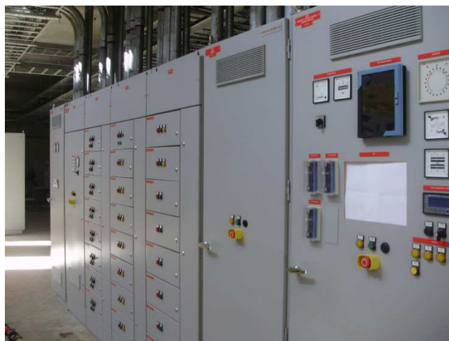
Figura 21 – Painéis de Proteção e Controle.
