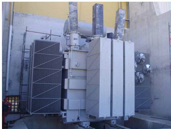
Figura 22 – Transformador elevador PCH Queluz –SP.
