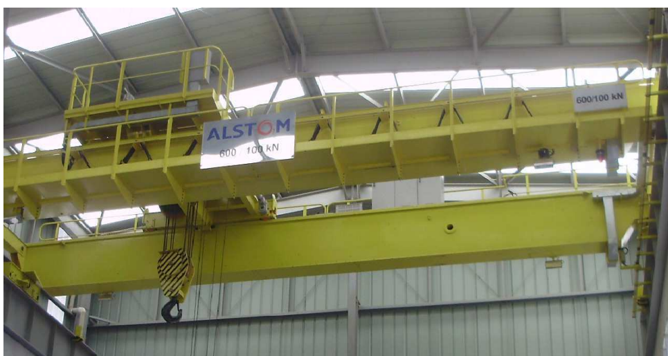
Figura 13 – Ponte Rolante da PCH Queluz- SP
