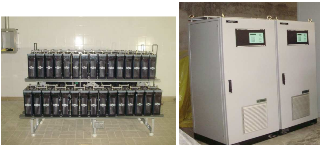
Figura 17 – Banco de Baterias e Retificadores da PCH Queluz- SP.
