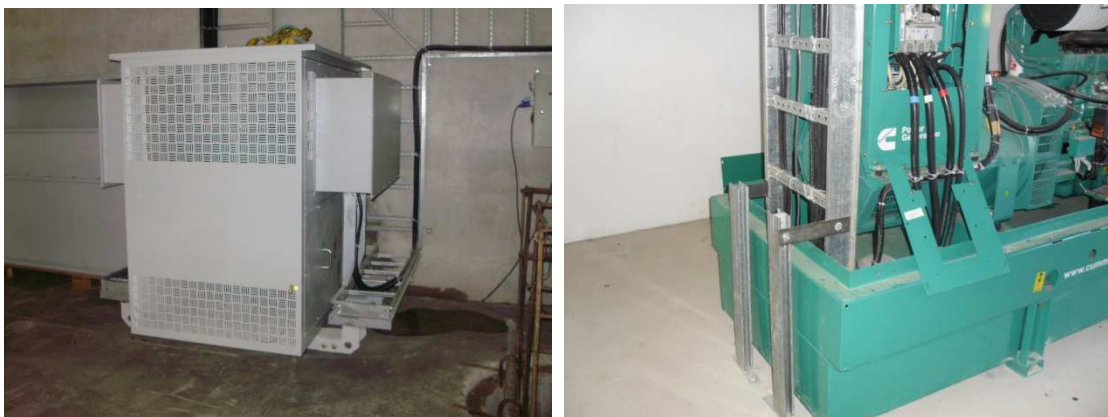
Figura 16- Transformador Auxiliar e Gerador Diesel PCH Queluz-SP
