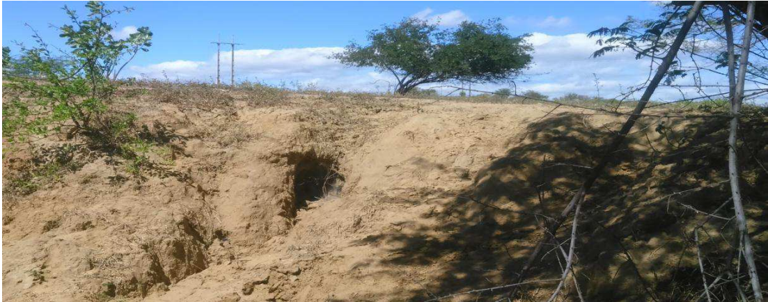
Figura 16 - Declividade acentuada onde se encontra o processo erosivo muito intenso.
