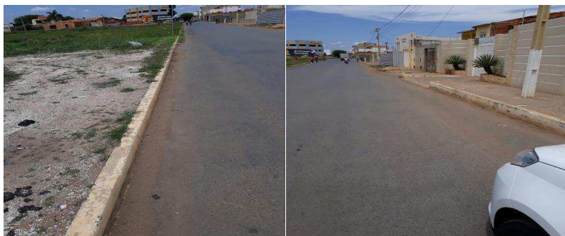
Figura 12 - Sarjetas ao longo de um dos trechos.
