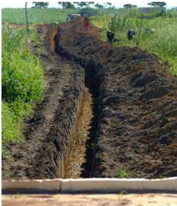
Figura 17 - Valas para cabos de média tensão Fonte - http://www.piniweb.com.br
