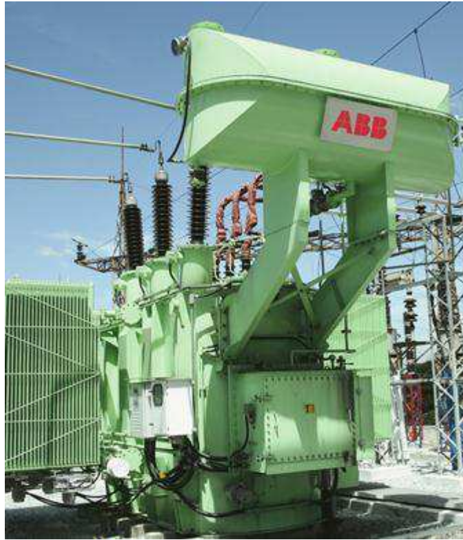
Figura 13: Transformador de potência ecológico resultado da parceria entre CEMIG e ABB.
