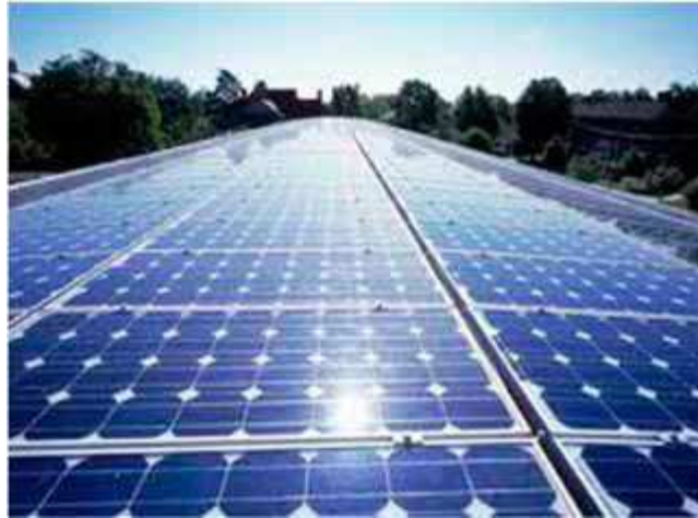
Figura 2.5 -Conjunto de módulos de silício monocristalino utilizados para produzir energia elétrica
