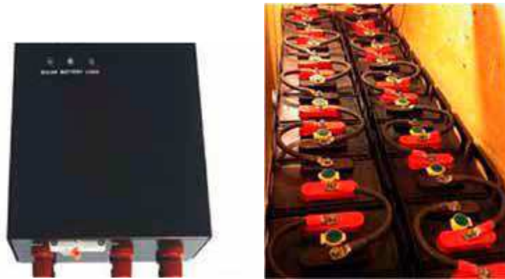
Figura 3.7–Controlador de carga (esquerda) e banco de baterias (direita).
