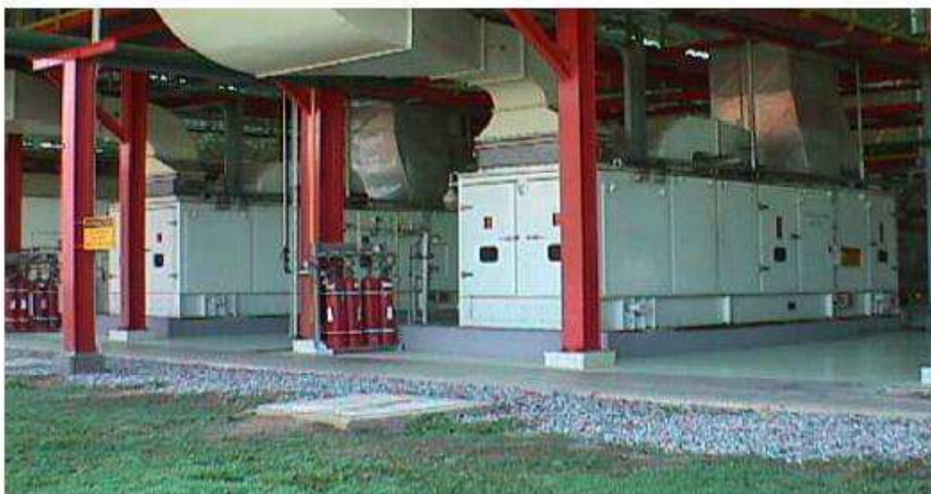
Figura 19 Sistema de turbinas a gás (Fábrica de Cerveja Brahma -Brasil)(apud (Brandão, 2004)).
