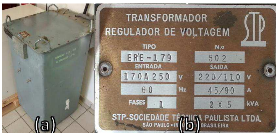
Figura 18. Transformador de Regulação monitorado.
