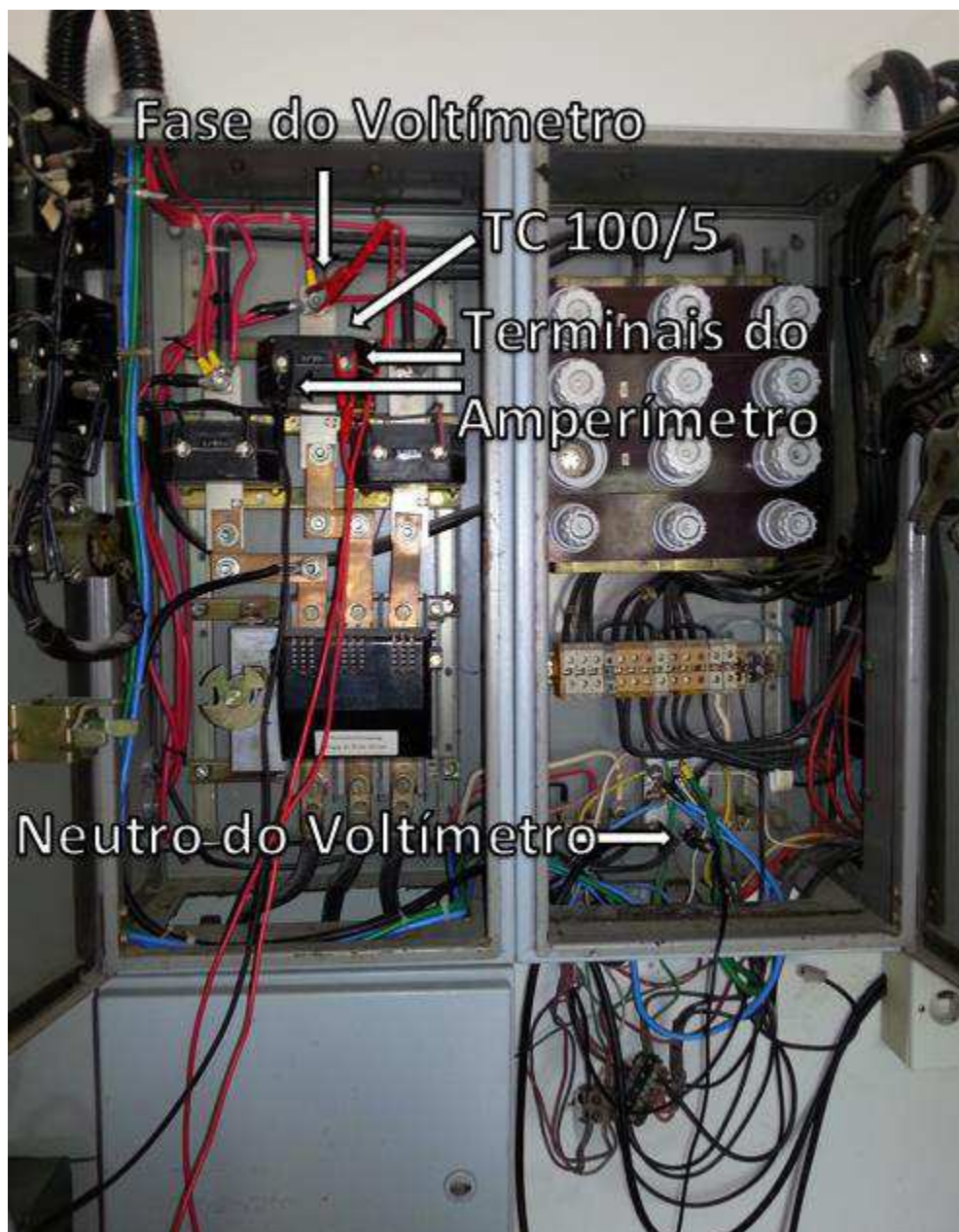
Figura 17. Conexões no quadro de distribuição do LAT
