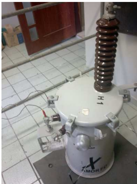
Figura 19. Transformador monofásico de 5 kVA, MRT, com núcleo de liga amorfa.
