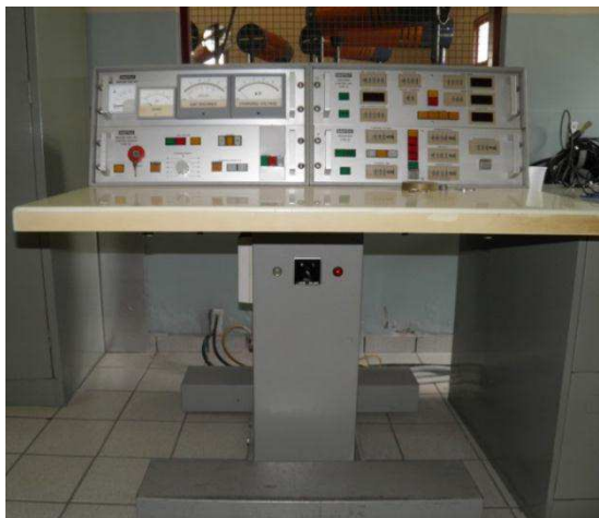
Figura 21 – Mesa de controle do gerador de impulso de corrente.
