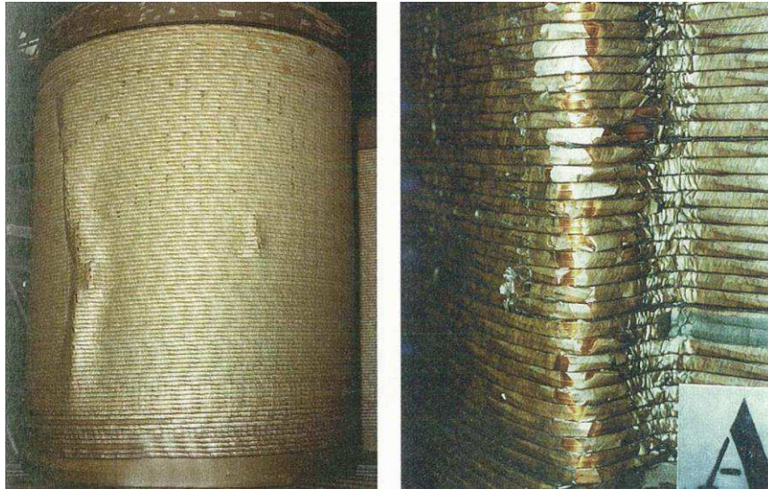
Figura 10 – Encurvamento livre ocorrido no enrolamento de baixa tensão de um transformador GSU. O enrolamento é do tipo camada com condutores continuamente transpostos.
