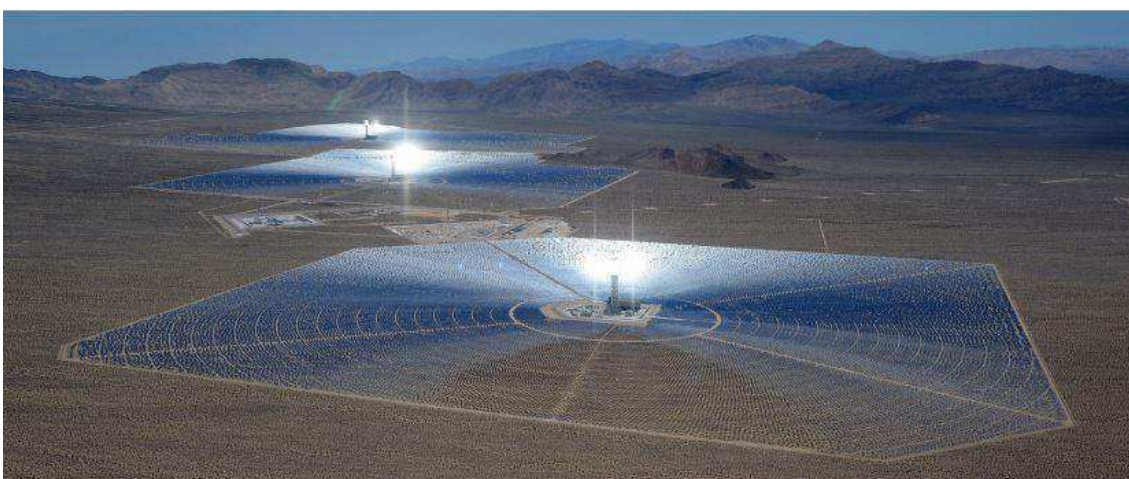
Figura 39: Sistema de geração solar elétrica de Ivanpah
