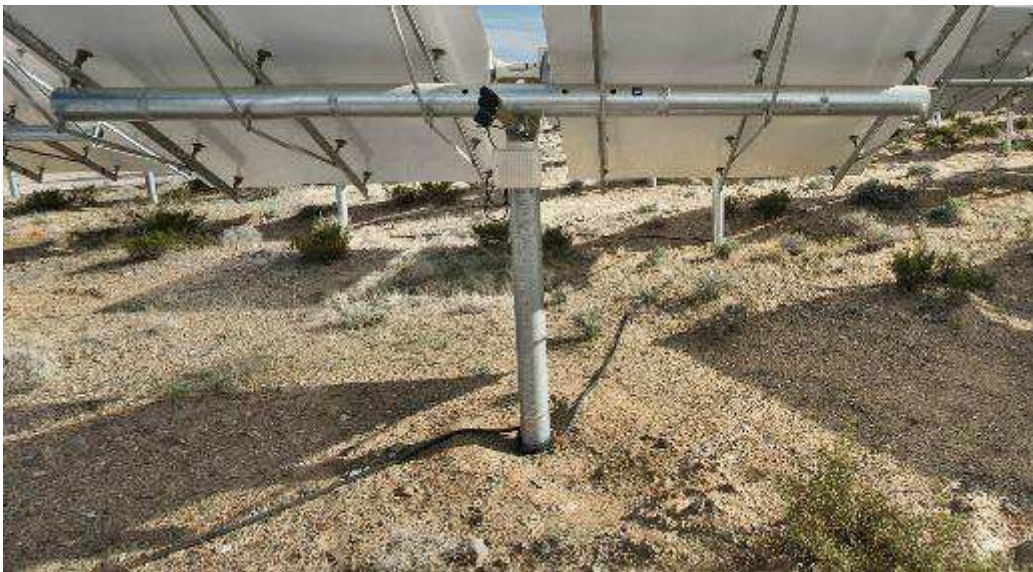
Figura 42: Suporte de um heliostatos inserido diretamente no solo
