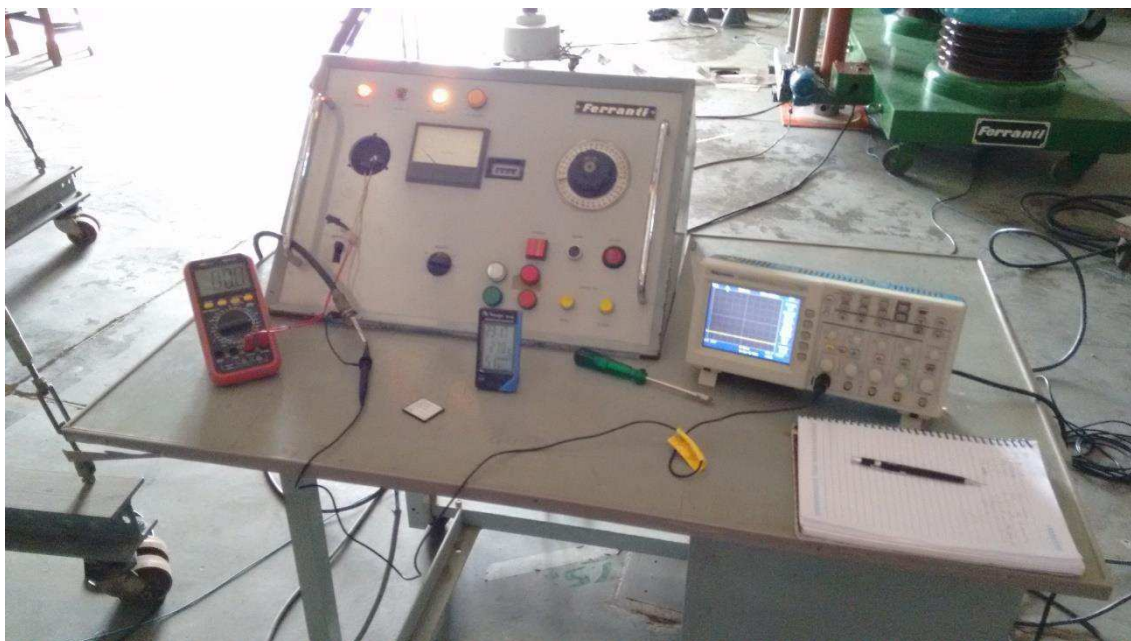
Figura 19 – Mesa de comando do gerador.
