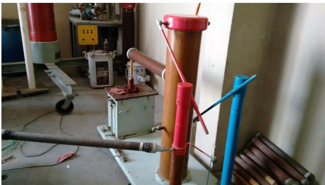
Figura 16 – Transformador e retificador.
