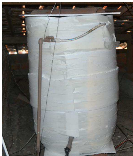
Figura 15 - Reservatório térmico revestido com isopor.
