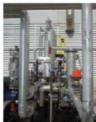
Figura 16: Sistema de purificação do biogás
