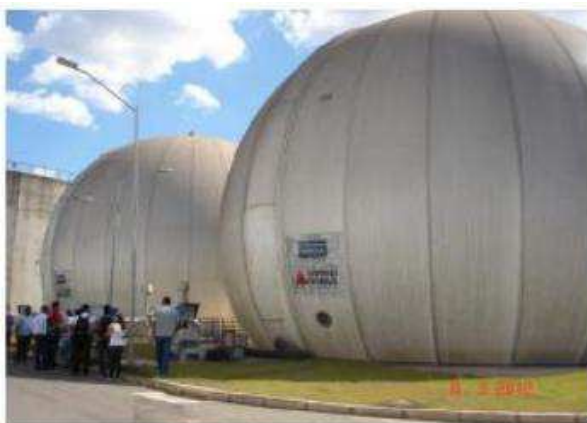
Figura 15: Gasômetros para armazenamento de biogás
