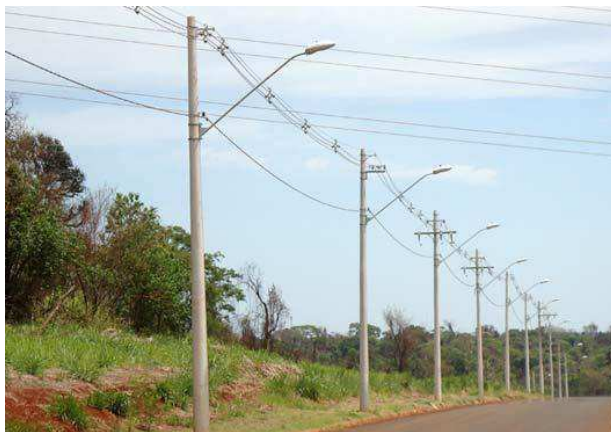
Figura 2 - Rede de Distribuição aérea.
