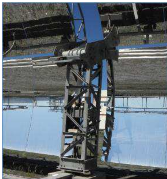
Figura 18 – Mecanismo hidráulico do sistema de rastreamento
